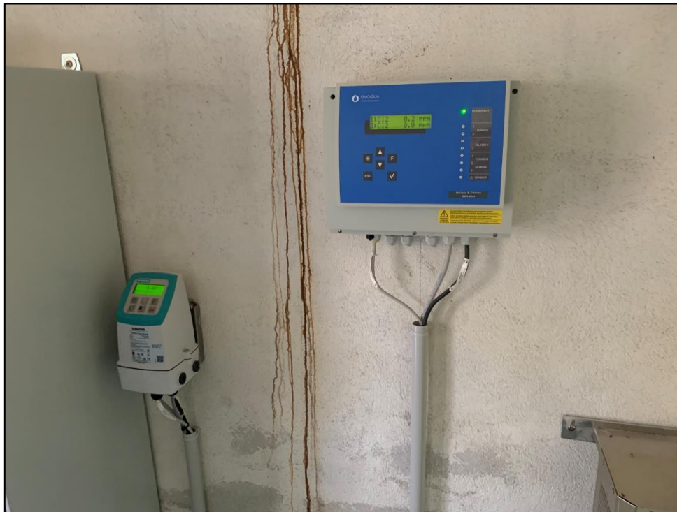
Figure 7 : Mesure du débit (gauche) et du chlore (droite) dans le local technique
