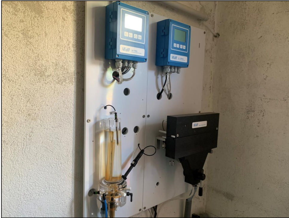
Figure 6 : Mesure de la turbidité des eaux du forage dans le local technique
