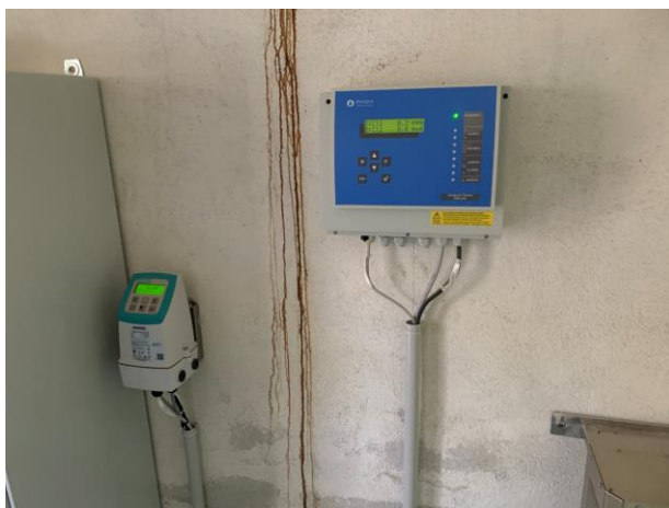
Figure 14 : Suivi de l'injection de chlore dans le local
